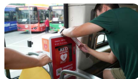
公交 AED 设备均安装在公交车上 显眼、方便取用的位置
